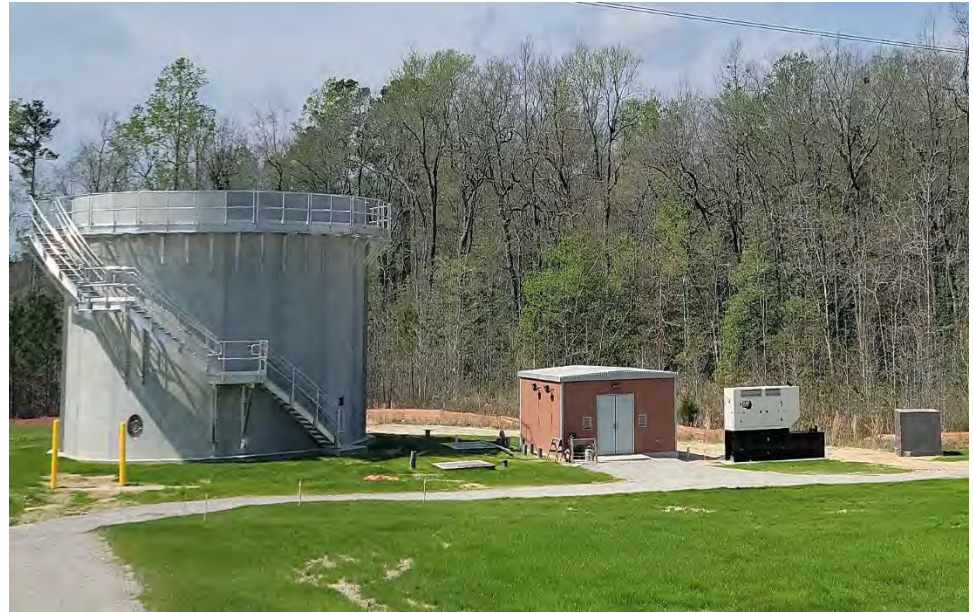
Industrial Park PS & EQ Tank
