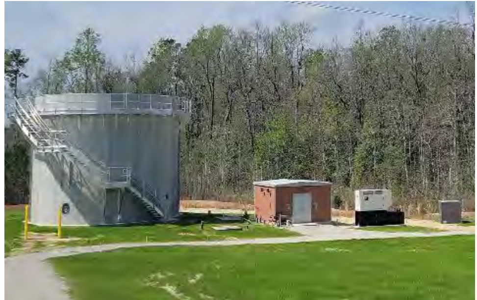
Industrial Park PS & EQ Tank
